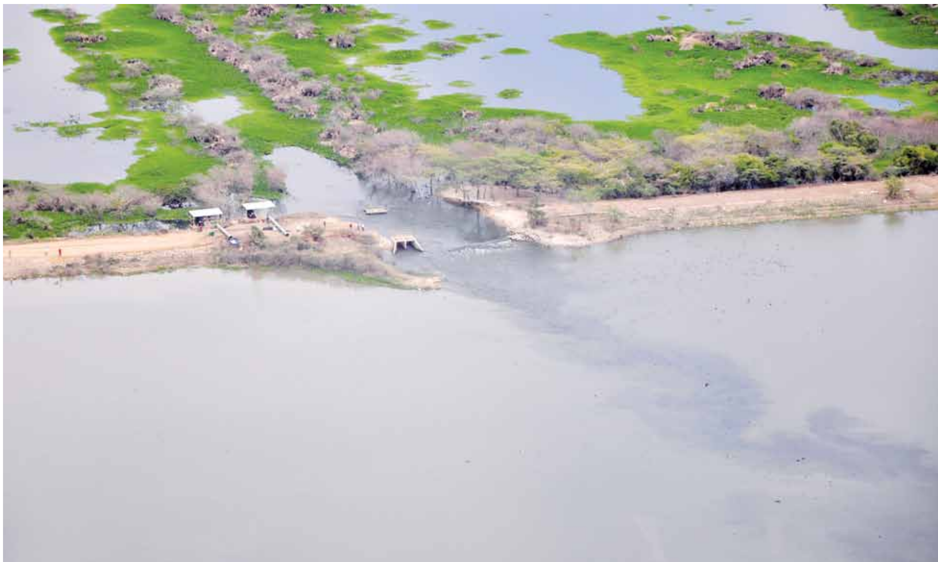
Para la evacuación de las aguas por gravedad se abrieron varios boquetes, como este en la presa Polonia en el embalse El Guájaro, que ahora deben ser tapados ante la subida del río.
