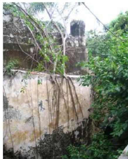
Figura 8. Aljibe a nivel de piso. Parte superior.
